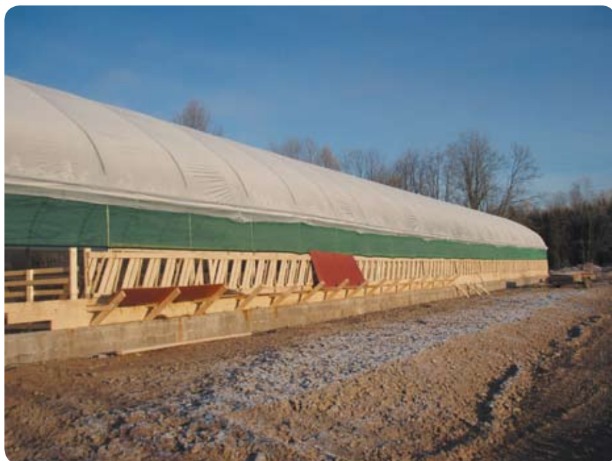
Fårbuset på Råum är av växthustyp med utfodringen längs utsidorna. På bilden är foderkrubborna under konstruktion.
